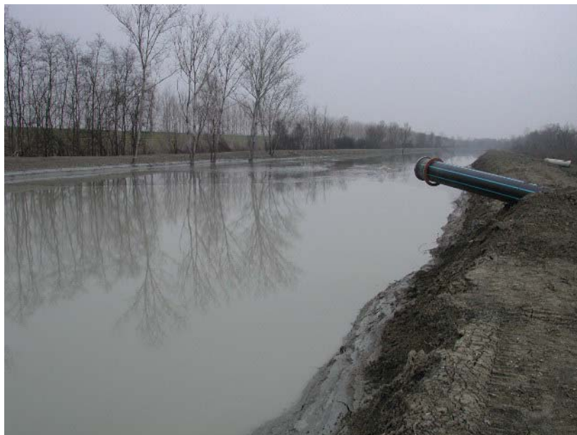
Fig. 3 – Sovralzo dell'arginatura in sinistra Canale Emissario e deposito del materiale dragato (Fonte: Consorzio della Bonifica Renana).
