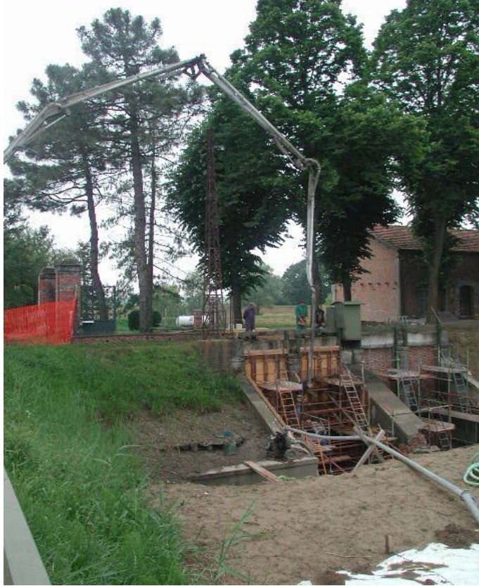
Fig. 10 – Altra fase di lavoro con riporto di malta cementizia (Fonte: Consorzio della Bonifica Renana).
